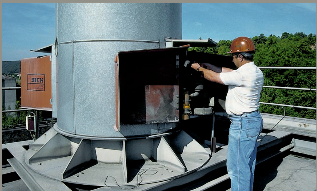
Wartung der EMISSIONS- ÜBERWACHUNG am Kamin
