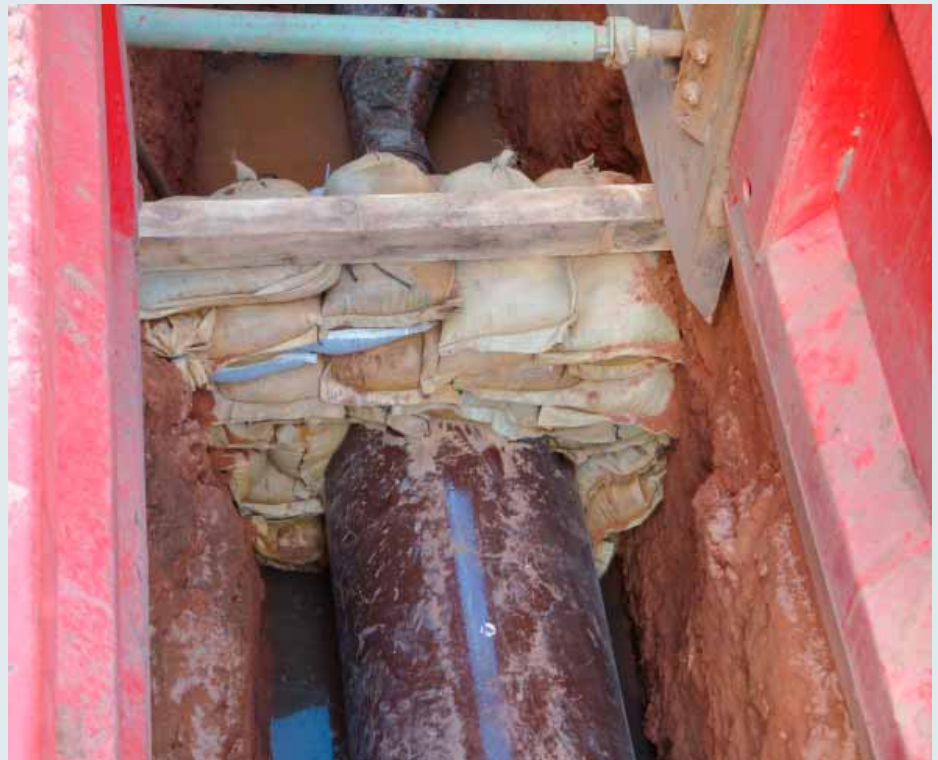
Abbildung 2: Beispiel einer Abschalung (Sandsackbarriere)
